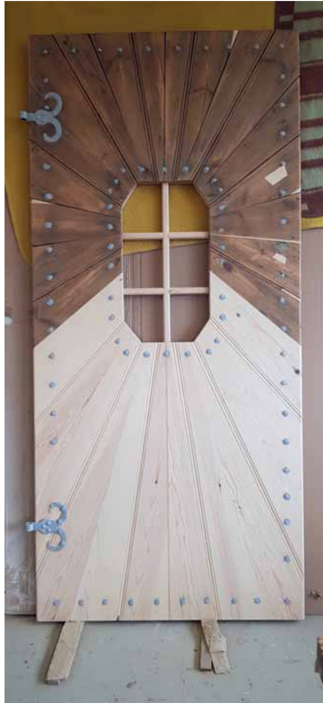
22 Aufarbeitung der Eingangstür an der Südfassade. Die fehlende strahlenförmige Aufdoppelung im unteren Bereich wurde wiederhergestellt und an den übrigen Hölzern geschädigte Bereiche ersetzt. Foto: pmp Architekten, 2019.
