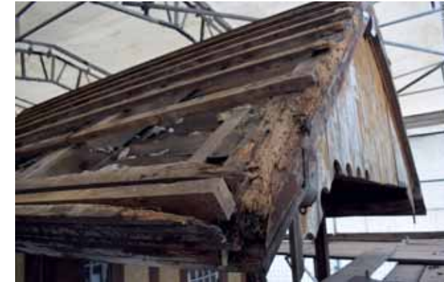
18 Geschädigter Ortgangsparren am Mansardgiebel des Bootshauses. Foto: pmp Architekten, 2019.
