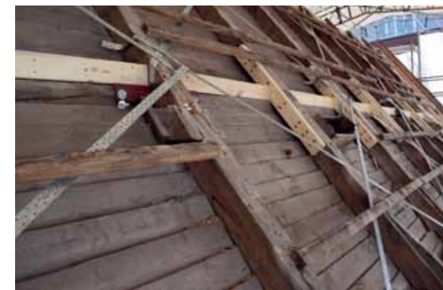
20 Reparatur der Dachkonstruktion des Hauptdaches, Beilaschungen, Stahlverbindungen und Windrispen zur Herstellung der horizontalen Aussteifung. Foto: pmp Architekten, 2019.
